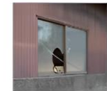
窓が割れた管理不全空家
